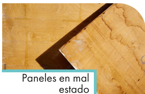
Suelos de madera en mal estado
